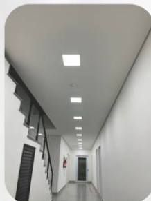
Forro em Drywall
